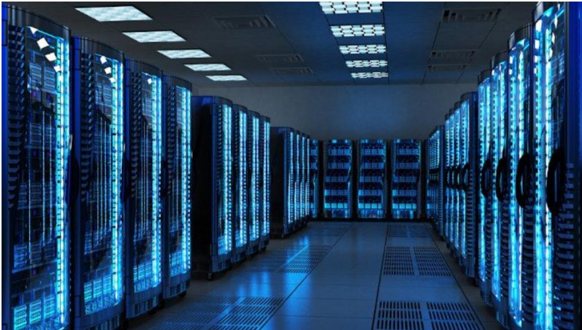
Abbildung 20: Professionelles Rechenzentrum [Online abgerufen: https://www.it-daily.net/it-management/data-center/wie-sieht-ein-modernes-monitoring-der-rechenzentrums-infrastruktur-aus , am 10.05.22; 13:30 Uhr]
